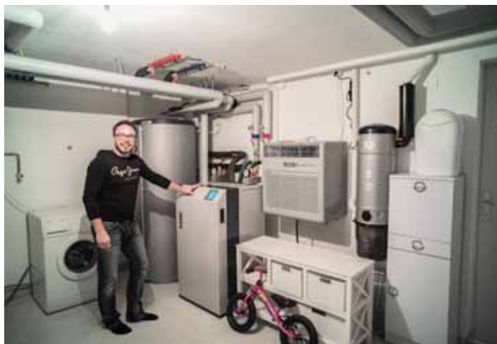
A la cave, la pompe à chaleur géothermique.
